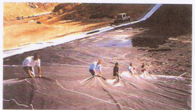
Anwendungsbeispiele der Firestone-Speichersee-Abdichtung in Andorra (o.), Cerdanyola (m.) und Mt. Bondone (u). Fotos:Lanz
